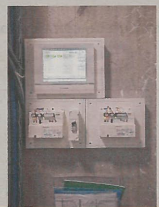
▲ Touch Manager permet de créer des plans pour les dépenses énergétiques, et de surveiller la consommation d'énergie. Ce système transmet des alertes sur les zones les plus énergivores, de façon à mettre en place les mesures nécessaires pour réduire la consommation. De même, les dépenses énergétiques peuvent être maîtrisées de façon plus poussée en activant la fonction d'asservissement qui désactive les unités en cas d'ouverture de fenêtres.
