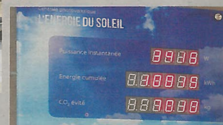
▲ Dans le hall d'entrée a été installé un écran de monitoring qui indique, en temps réel, les informations issues de la centrale photovoltaïque située sur le toit : puissance instantanée produite par les panneaux, énergie produite depuis le démarrage de la centrale et CO 2 évité.
